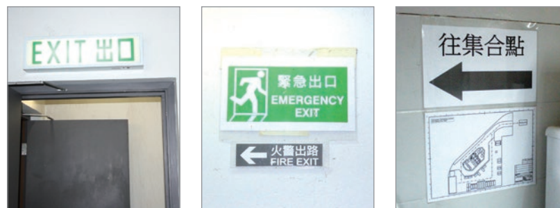
消防逃生出口指示燈及緊急出口指示
