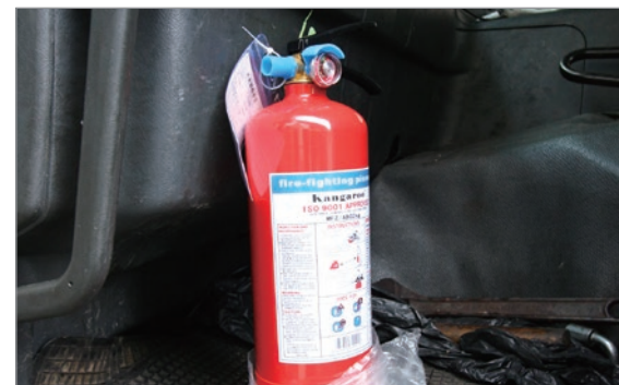
擺放在運輸車輛內的滅火筒
