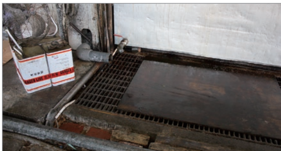
廢置食用油廠內的污水處理設施
