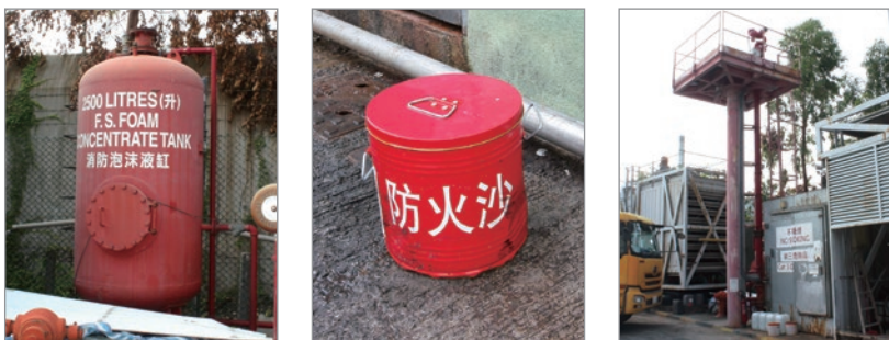
不同類型的滅火設備如消防泡沫、防火沙、滅火桶及消防喉等
