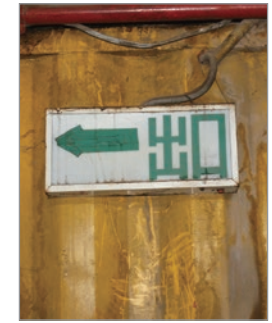
緊急出口指示燈，指示員工離開場所
