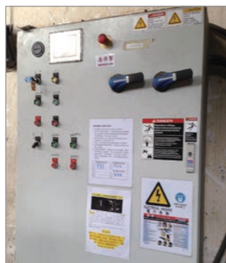
在電器裝置貼上危險警告及安全操作須知(包括負責註冊電業工人聯絡資料)
