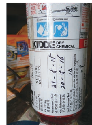
定期檢查滅火裝置
